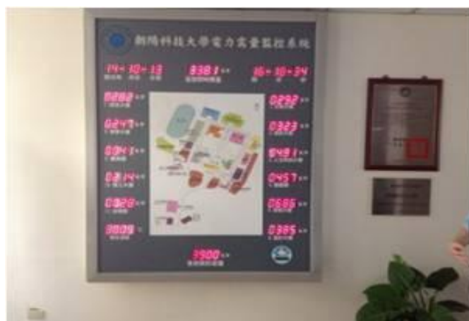
朝阳科大的电力监控系统
